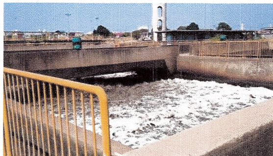
Figura 40 - Tanque de Aeração
