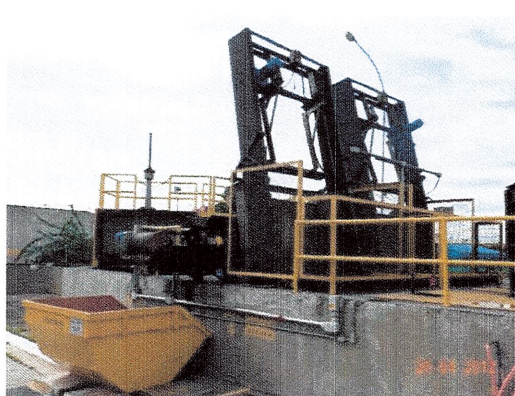
Figura 38 - Gradeamento grosso Fonte: Sabesp
