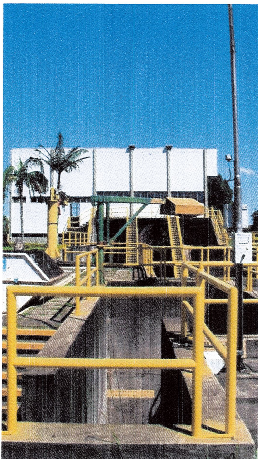
Figura 35 - Elevatória de Esgoto Final Fonte: Sabesp
