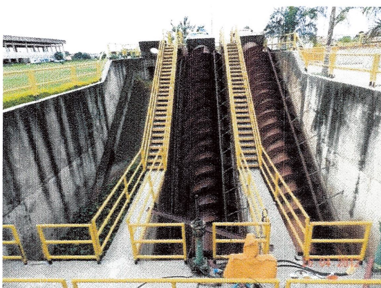
Figura 43 - Elevatória de recirculação de lodo
