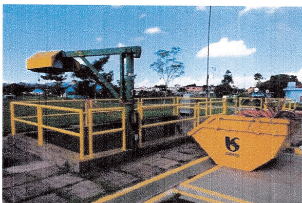
Figura 37 - Gradeamento fino Fonte: Sabesp
